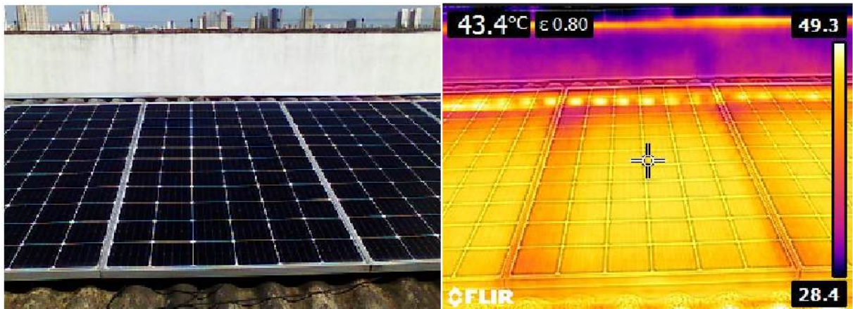
Figura 25 - Termografia em painéis limpos e sem sombra
