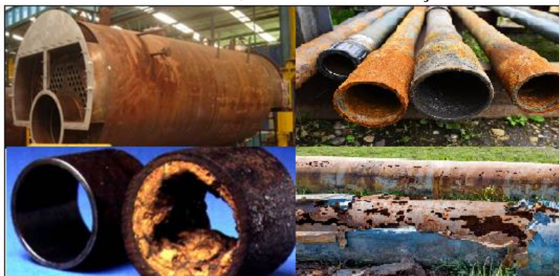
Figura 1 — Estrutura de caldeiras, corrosão e incrustações de tubos
